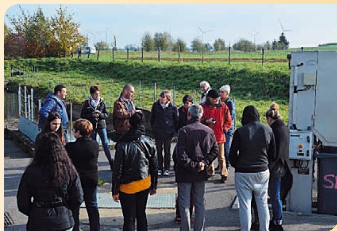
Poste de relevage principal, dégrilleur et visiteurs
