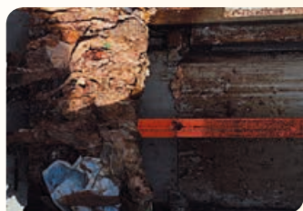
Dégrilleur (lingettes et déchets)
