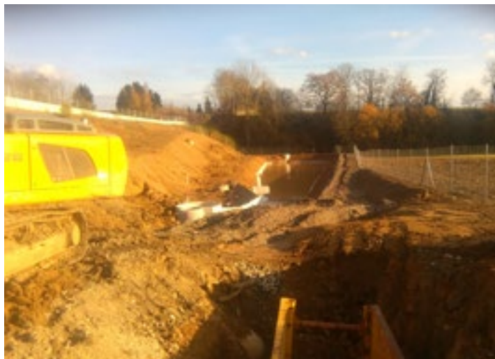
Bassin de rétention côté Gebolsheimbach
