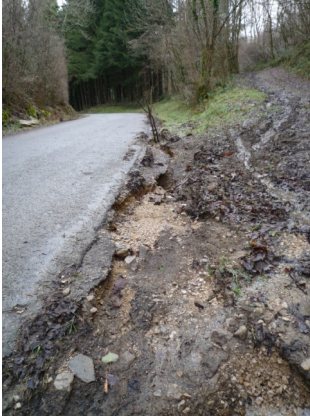
Dégradations à l'intersection du CV n°4 et du Chemin du Chénard
