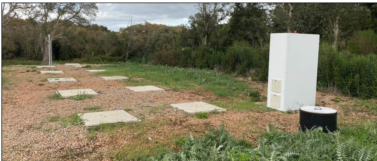
Figure 17 : Photographie de la STEU de Salva di Levo (novembre 2022)
