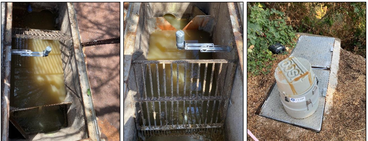
Figure 18 : Photographies du seuil déversoir et du préleveur automatisé lors des mesures d’août 2022
